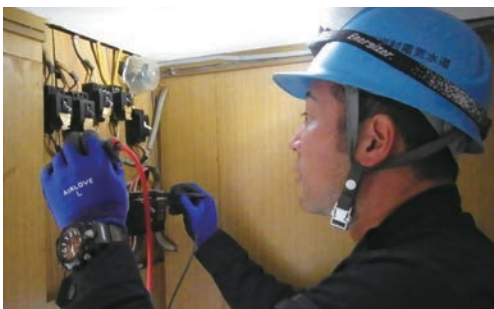
家庭内の配電盤の確認作業を行う南宇和電気工事組合の岩村真典理事長
