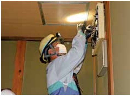
▲配電盤の確認作業を行う四国電気保安協会の山下耕二さん
