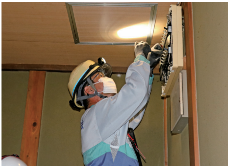
▲配電盤の確認作業を行う四国電気保安協会の山下耕二さん
